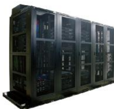
■電子カルテ用サーバー
