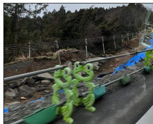
崩落した高速道路
